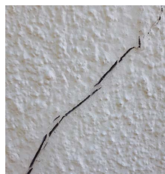
Lézardes DTU 20.1, pour les maçons
