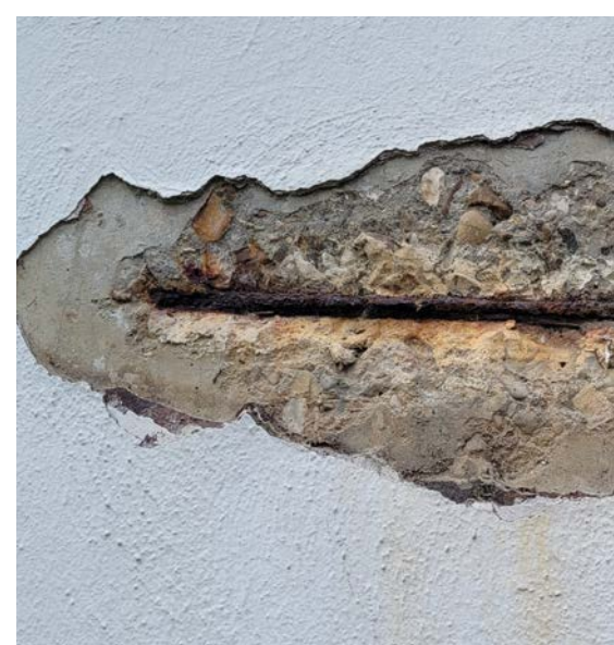
Éclats de béton
